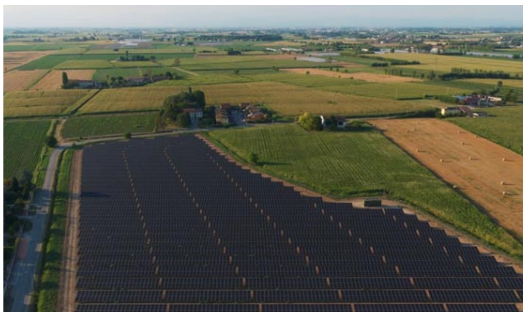
L'impianto fotovoltaico di Nogara
