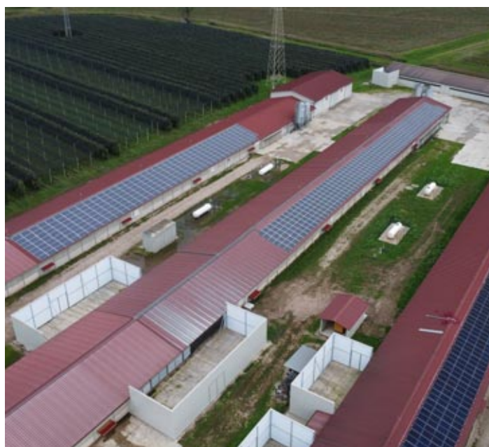
Un impianto fotovoltaico industriale
