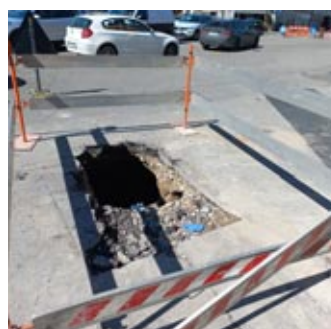
Il cedimento in via Polveriera Vecchia
