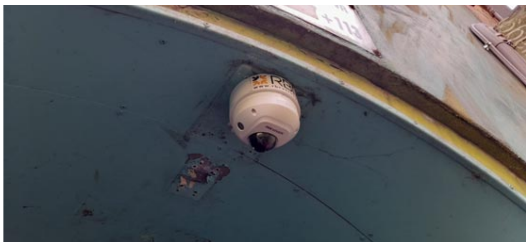
Ripristinate le telecamere danneggiate da un atto vandalico
