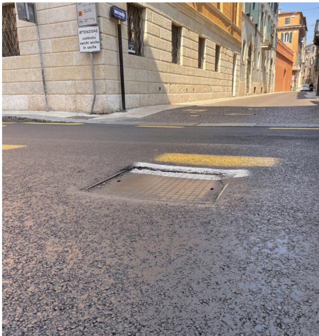
La recente asfaltatura in Centro non ha rispettato i livelli dei tombini
