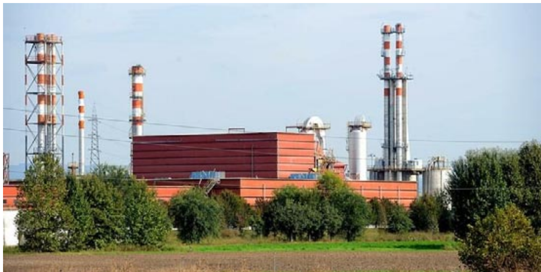
L'impianto di Ca' del Bue
