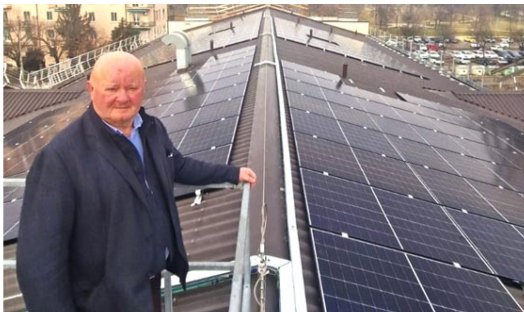
Il presidente dell'Esu Claudio Valente sulla copertura della residenza di Piazzale Scuro dove sono stati installati 288 pannelli fotovoltaici
