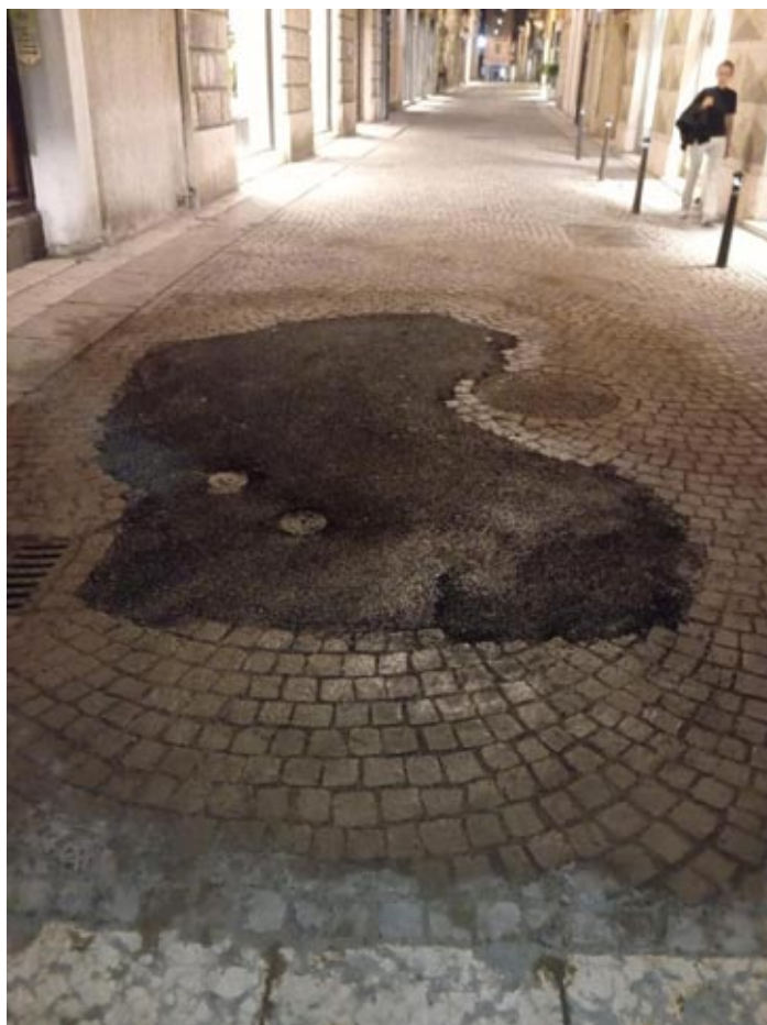
Si è concluso come previsto l'intervento di riparazione da parte di Acque Veronesi su una vecchia condotta danneggiata che aveva provocato una fuoriuscita di acqua in via Quattro Spade, ma "el tacon l'è peso del buso". Sarà quindi necessario l'intervento risolutivo degli esperti posatori di porfido
