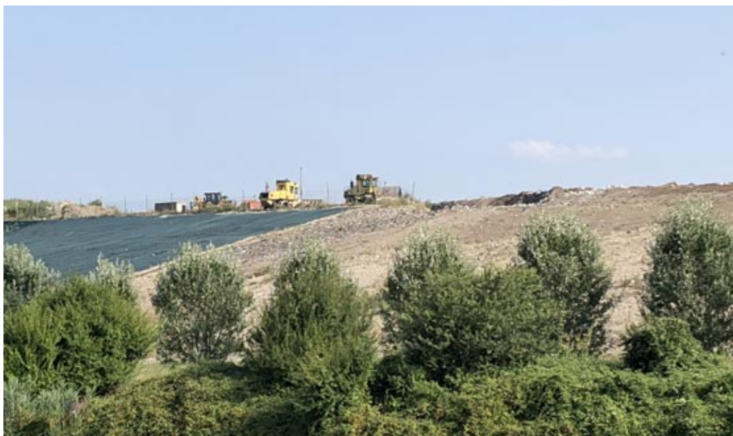
La discarica di Torretta a Legnago
