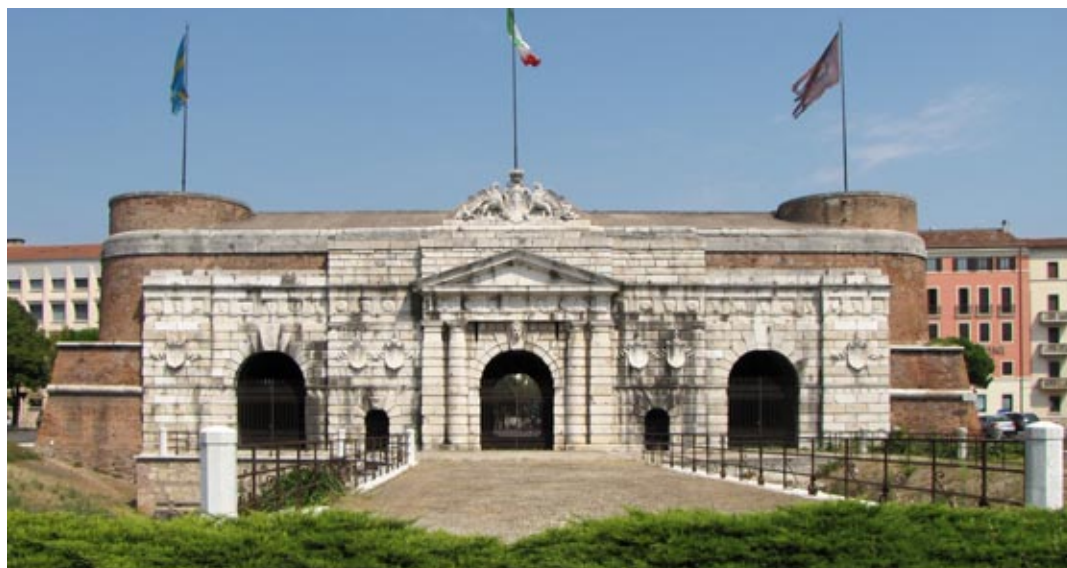
La copertura piana di Porta Nuova interessata da infiltrazioni d'acqua piovana
